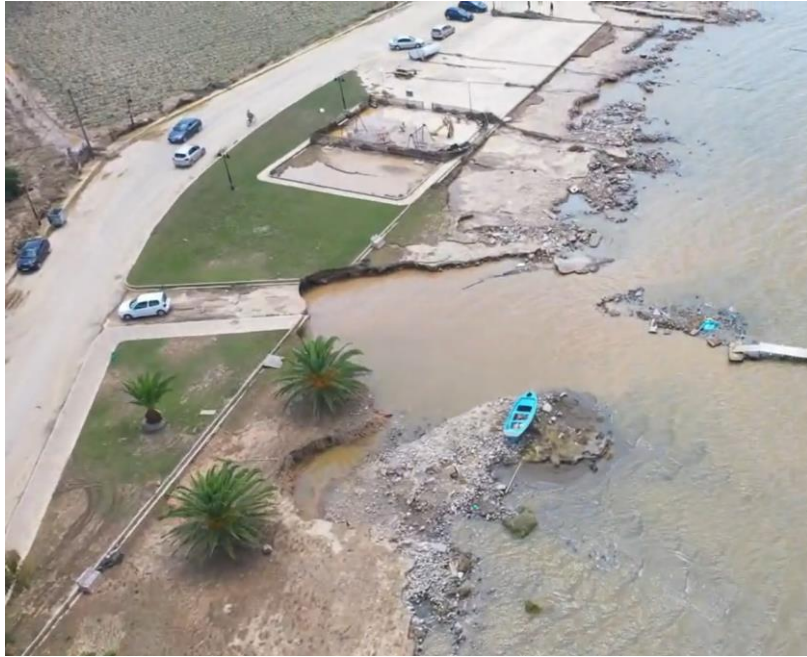
Εικόνα 18: Διάβρωση επί της ακτής στην περιοχή Λευκαντί, μετά την πλημμύρα του 2020 στον Λήλαντα. (Πηγή: ΕΚΠΑ 2021).
