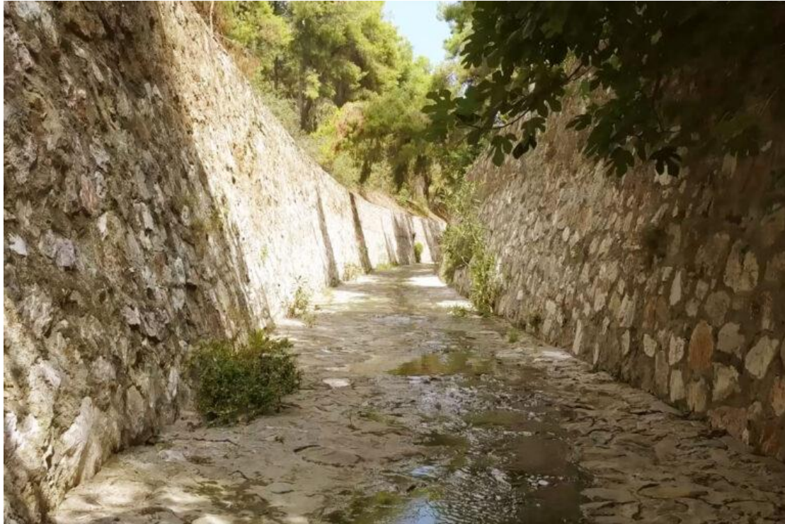
Εικόνα 4: Τσιμέντινοι ή λιθόκτιστοι αγωγοί αντικαθιστούν τη φυσική κοίτη και τα πρανή του ρέματος μετά το 2000.
