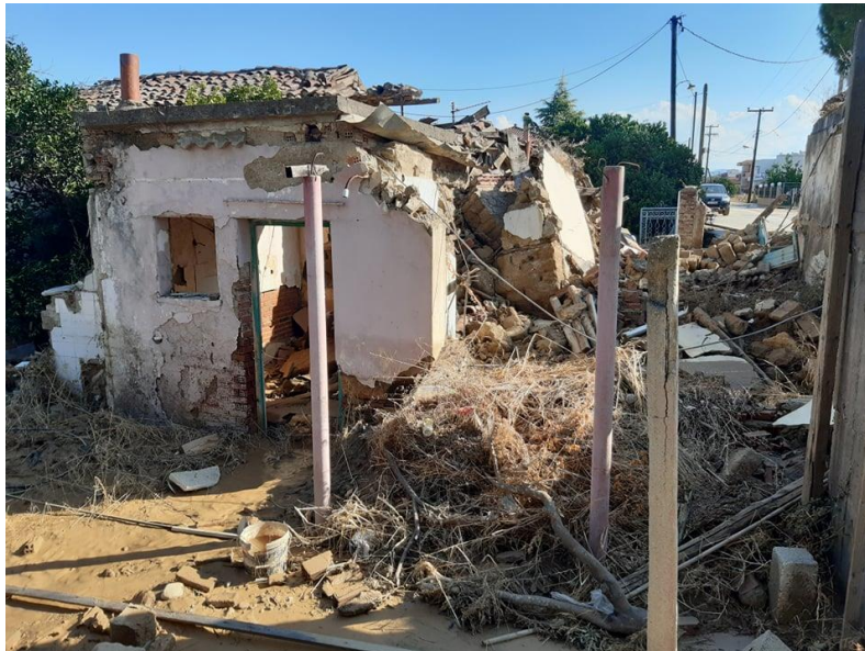
Εικόνα 19: Κατεστραμμένη οικία μετά την πλημμύρα του 2020 στον Λήλαντα. Επισημαίνεται ότι η συγκεκριμένη κατοικία ήταν κατασκευασμένη σε απόσταση λίγων μέτρων από την όχθη του ποταμού. (Πηγή: ΕΚΠΑ 2021).
