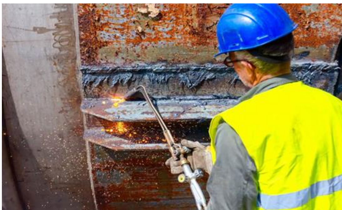
Εικόνα 57: Εργασίες με συγκόλλησης με την χρήση προστατευτικών μέτρων για την διασφάλιση της υγείας του εργαζομένου Πηγή: istockphoto.com
