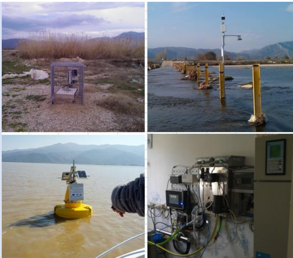
Εικ 8 Παραδείγματα εγκατάστασης Εξοπλισμού σταθμών Τηλεμετρίας
